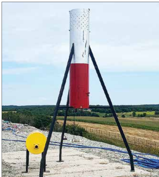
Fragment instalacji spalania biogazu
