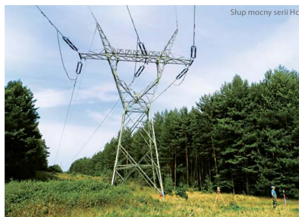
Linia elektroenergetyczna 220 kV relacji Łośnice – Kielce
