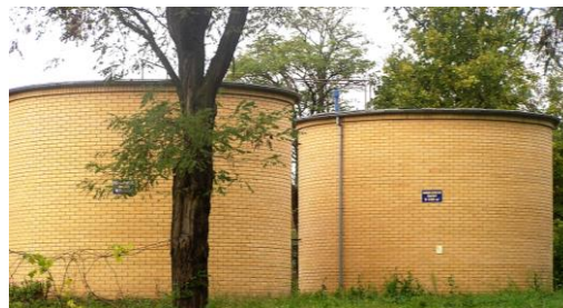
Zdjęcie 2. Stacja uzdatniania wody w Gołuchowie
