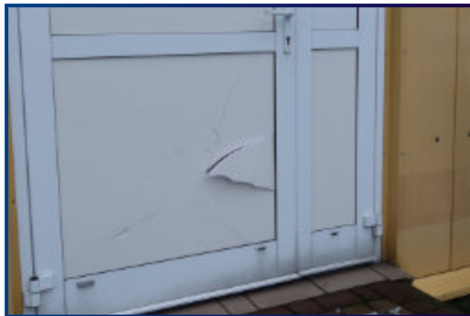
Uszkodzone drzwi w budyńku sali sportowej
